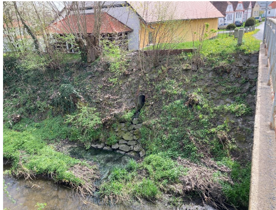
Výust' jednotné kanalizace.
