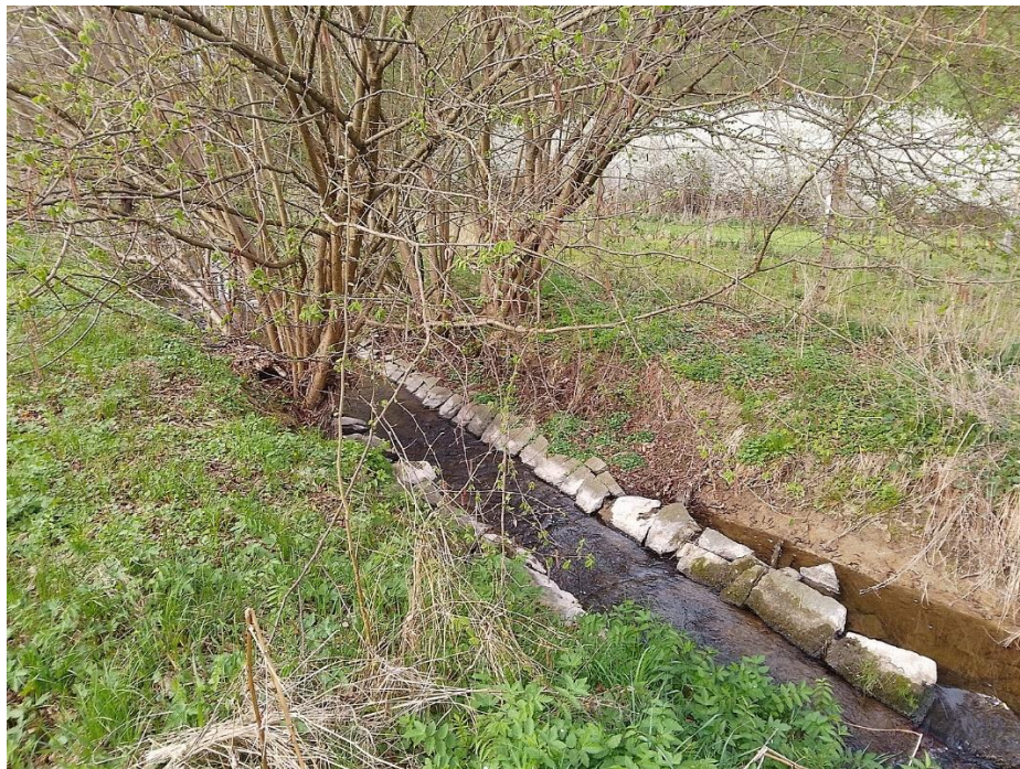
Zachovalé opevnění toku, degradující, problémem je zahloubení toku, které je problematické pro zajištění vodohospodářsky vhodné samovolné renaturace toku.
