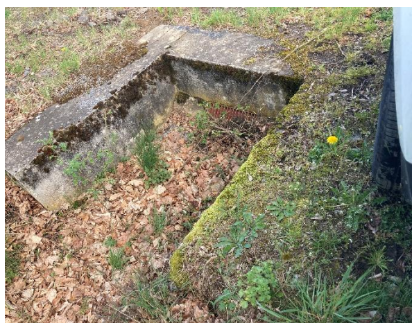
Foto 22: Zanesená vpust s česlemi před Horšicemi, do které ústí příkop podél lesní cesty (KP1)
