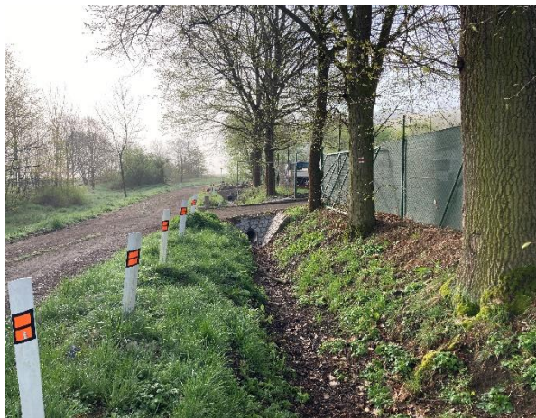
Foto 24: Odvodnění cesty od zříceniny hradu Skála, které při vyšších srážkách ohrožuje zástavbu Radkovic (KP6)
