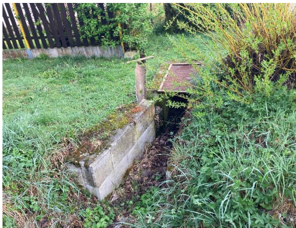
Foto 23: Kanalizační vpust nad Radkovicemi, kam ústí vody z lesní cesty u nebeského rybníčku (KP5)
