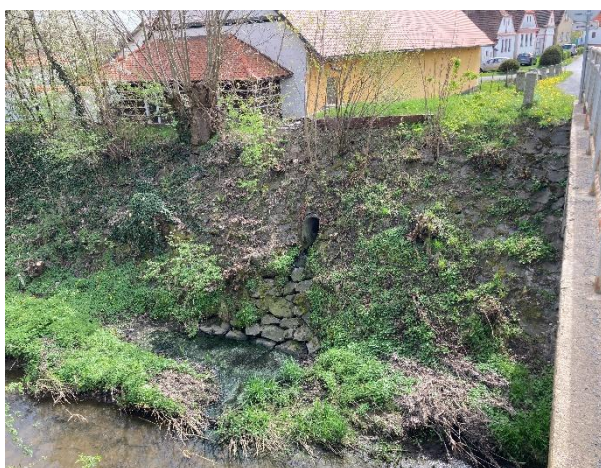
Foto 7: Výust' jednotné kanalizace do Zlatého potoka pod mostem v Radkovicích
