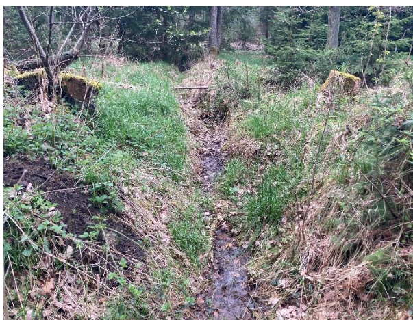
Foto 20: Páteřní odvodňovací koryto (IDVT 10268990) lichoběžníkového profilu odvodňuje okolí
